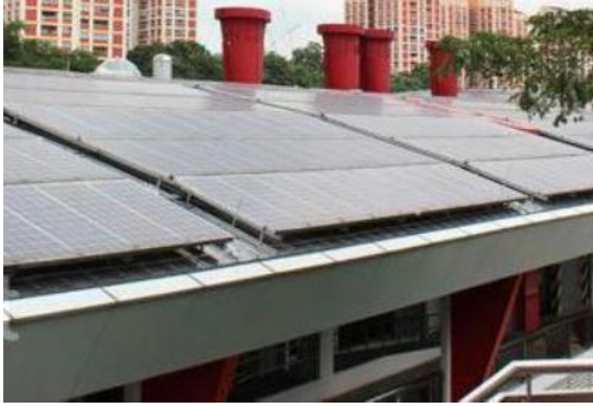
شكل ٧ يوضح الخلايا الشمسية المثبتة على سطح المبنى ٨
