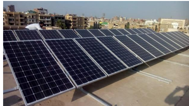
شكل ٢٣ يوضح الخلايا الشمسية المثبتة على مبنى كلية الهندسة جامعة بنها ٢٤
